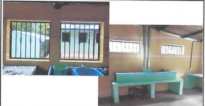
FOTO 2: INSTALACIÓN DE BALCONES Y ELABORACIÓN DE 2 ESTUFAS RURALES COMPLETA CON CHIMENEA CADA UNA
